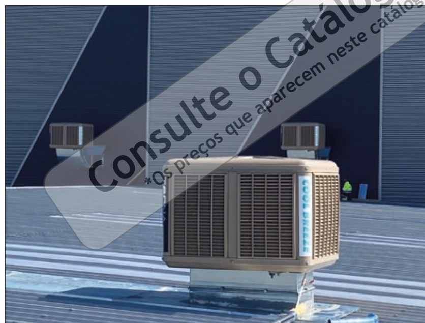
Instalação de 18 unid. QA-500 integradas com o controlo doméstico INTELLITOUCH no novo armazém da NISSAN (Ávila)
